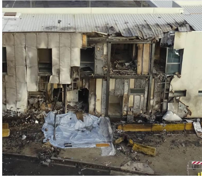
Foto 10: particolare dell'area di impatto dell'aeromobile contro l'edificio.
