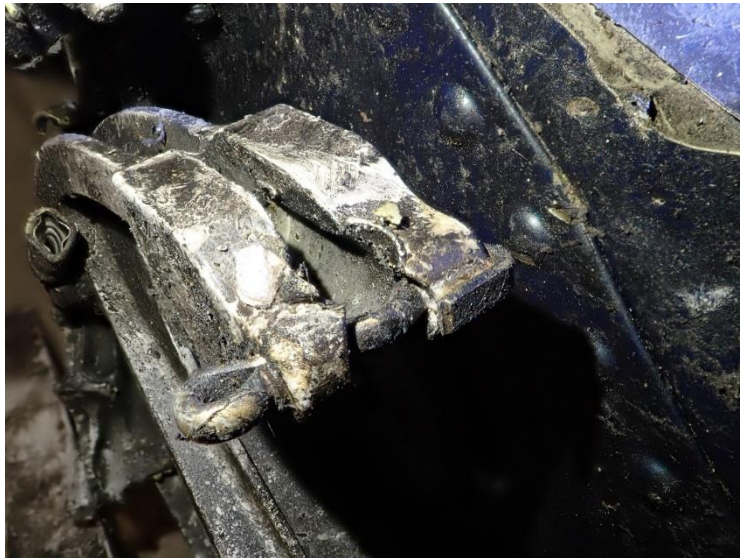
Foto 38: deformazione della sede di fissaggio del terminale sferico di uno dei due cavi del rudder al quadrante di controllo del timone di direzione.
